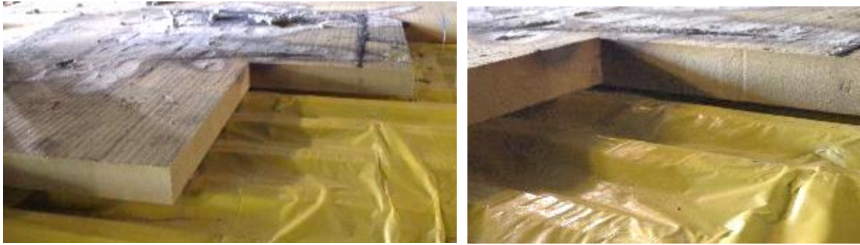
Fot. 9 Zniszczenia wewnątrz dolnej warstwy płyt z wełny mineralnej UKŁAD – 1 (zdjęcie autora opracowania)
