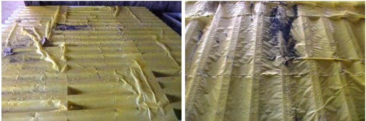
Fot. 10 Zniszczenia paroizolacji UKŁAD – 1 (zdjęcie autora opracowania)
