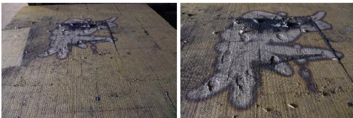
Fot. 8 Zniszczenia na powierzchni dolnej warstwy płyt z wełny mineralnej UKŁAD – 1 (zdjęcie autora opracowania)
