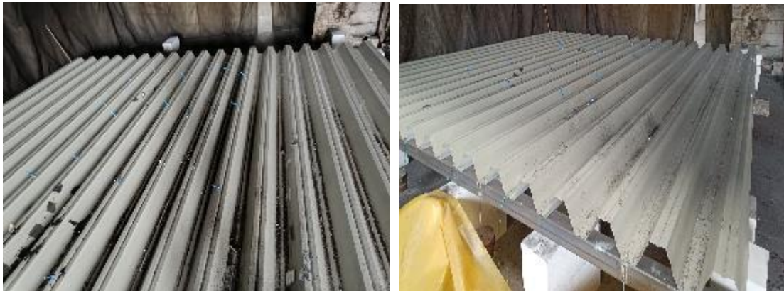
Fot. 16 Zniszczenia konstrukcji nośnej z blachy trapezowej UKŁAD – 2 (zdjęcie autora opracowania)
