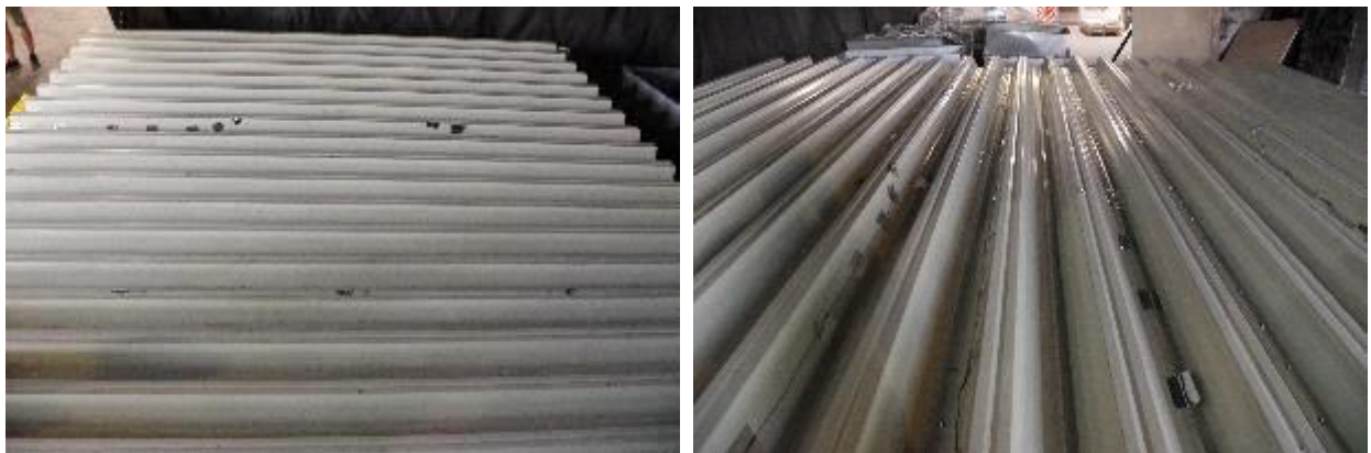
Fot. 11 Zniszczenia konstrukcji nośnej z blachy trapezowej UKŁAD – 1 (zdjęcie autora opracowania)
