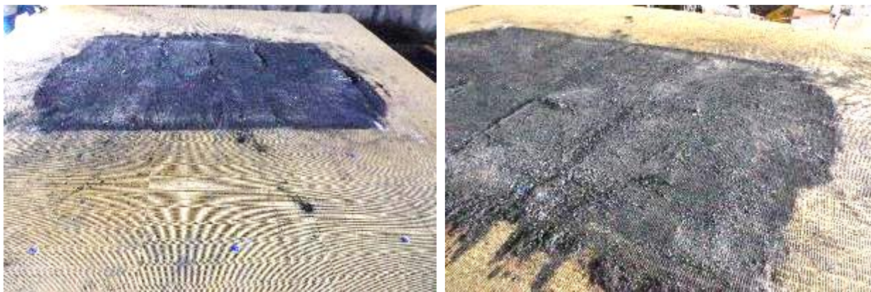
Fot. 6 Zniszczenia na powierzchni górnej warstwy płyt z wełny mineralnej po zdjęciu membrany dachowej i paneli fotowoltaicznych UKŁAD – 1 (zdjęcie autora opracowania)
