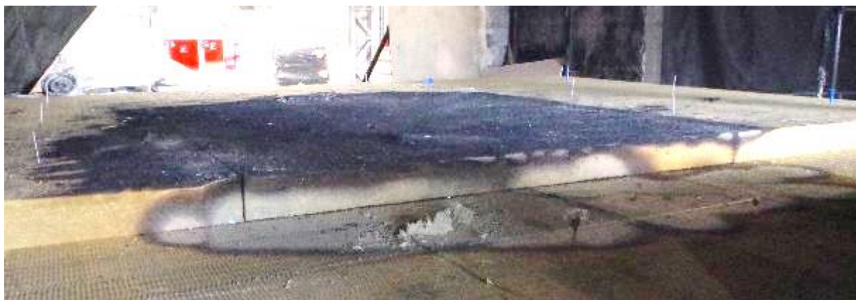
Fot. 7 Zniszczenia wewnątrz górnej warstwy płyt z wełny mineralnej UKŁAD – 1 (zdjęcie autora opracowania)
