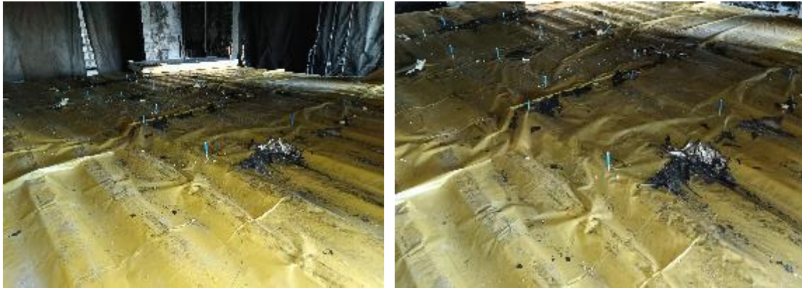
Fot. 15 Zniszczenia paroizolacji UKŁAD – 2 (zdjęcie autora opracowania)
