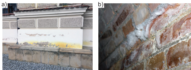
Przykład zawilgoconia kapilarnego (a) i wysoleń na konstrukcji murowej (b) [Fot. B. Ksit] Example of capillary moisture (a) and seals on a masonry structure (b)
